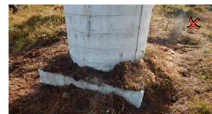
Figur 19: Ikke god overgang mellom stabbe og terreng. Massene oppå betongen vil tørke ut.
