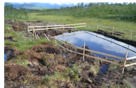
Figur 39: Etabler sedimentsjonsbasseng for håndtering av vann fra byggegrøp for mastepunkt. Bassenget fylles igjen etter bruk..
