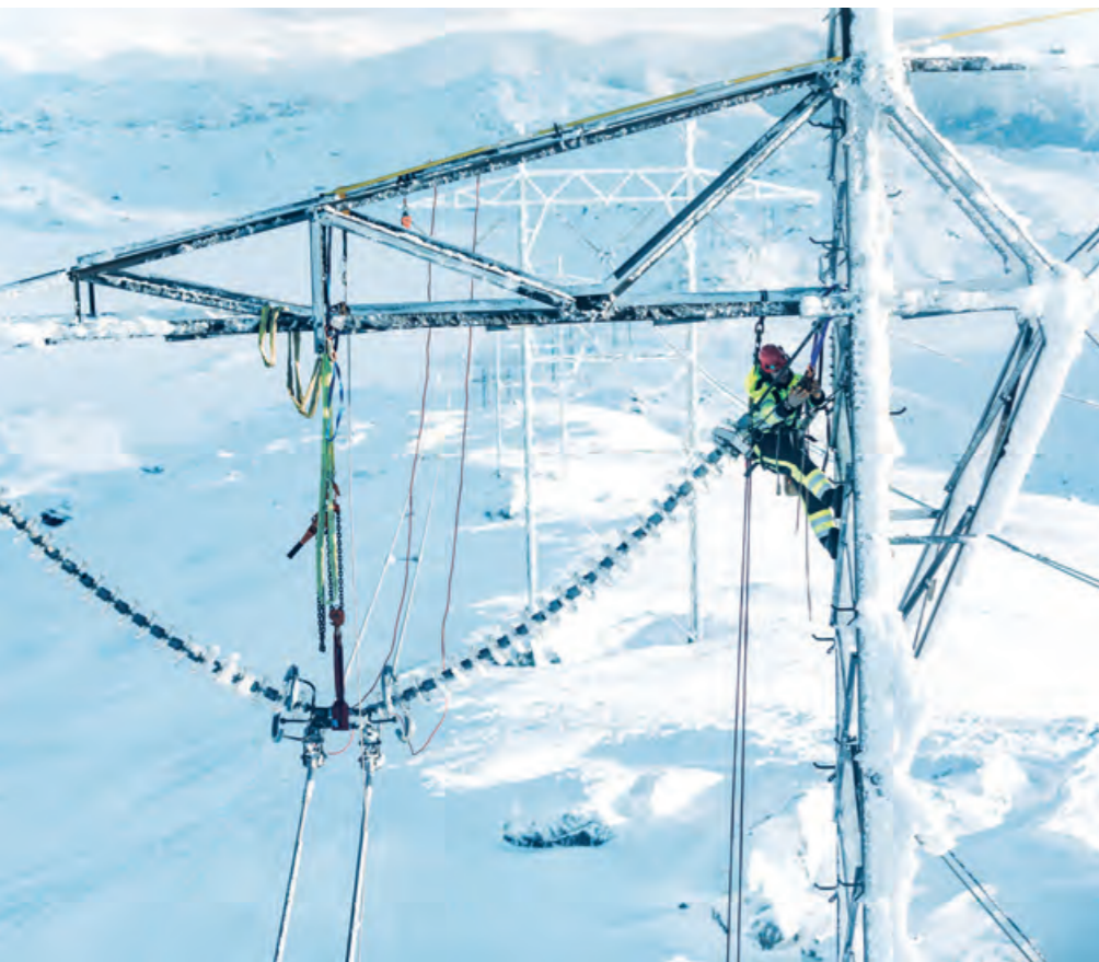
De nye sensorene som blir montert sender data om hvor mye høyspentledningen veier, og når de må avises, direkte via 4G-nettet.
