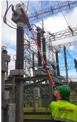
Bruk av kamera med isolerstang.
