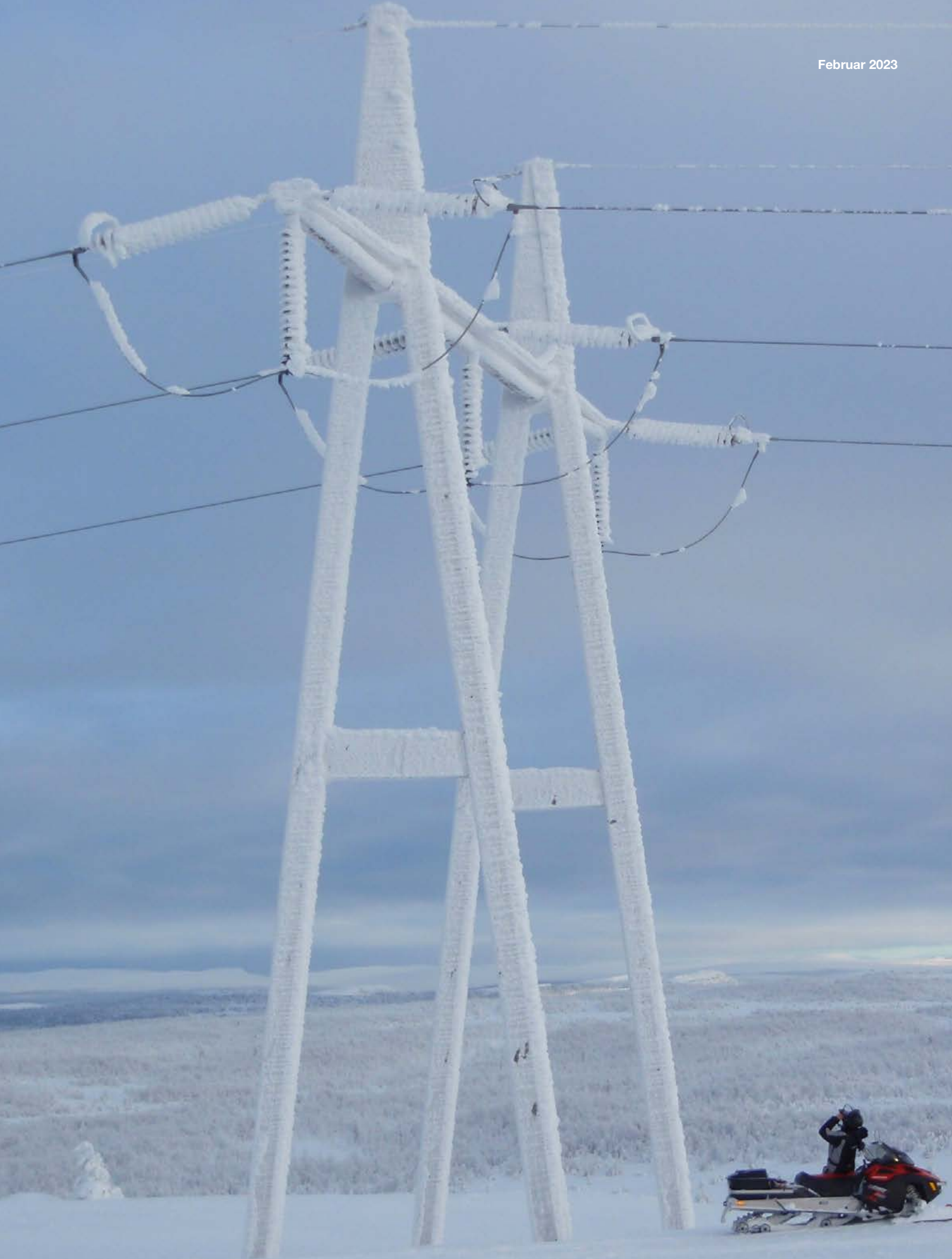
Nedre Vinstra-Fåberg 300kV. Foto: Runar Stang, Statnett
