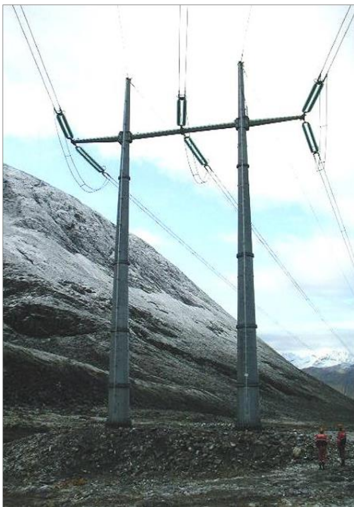
Figur 21. 420 kV skredmast (forankringsmast)
