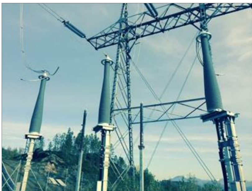
Figur 22. Kabelendemast. Konstruksjonen består av en forankringsmast og en elektrisk overgang mellom luftledning og jordkabel. En lignende løsning planlegges brukt ved kabling av 300 kV-ledningen Sauda-Nesflaten ved Sauda transformatorstasjon.
