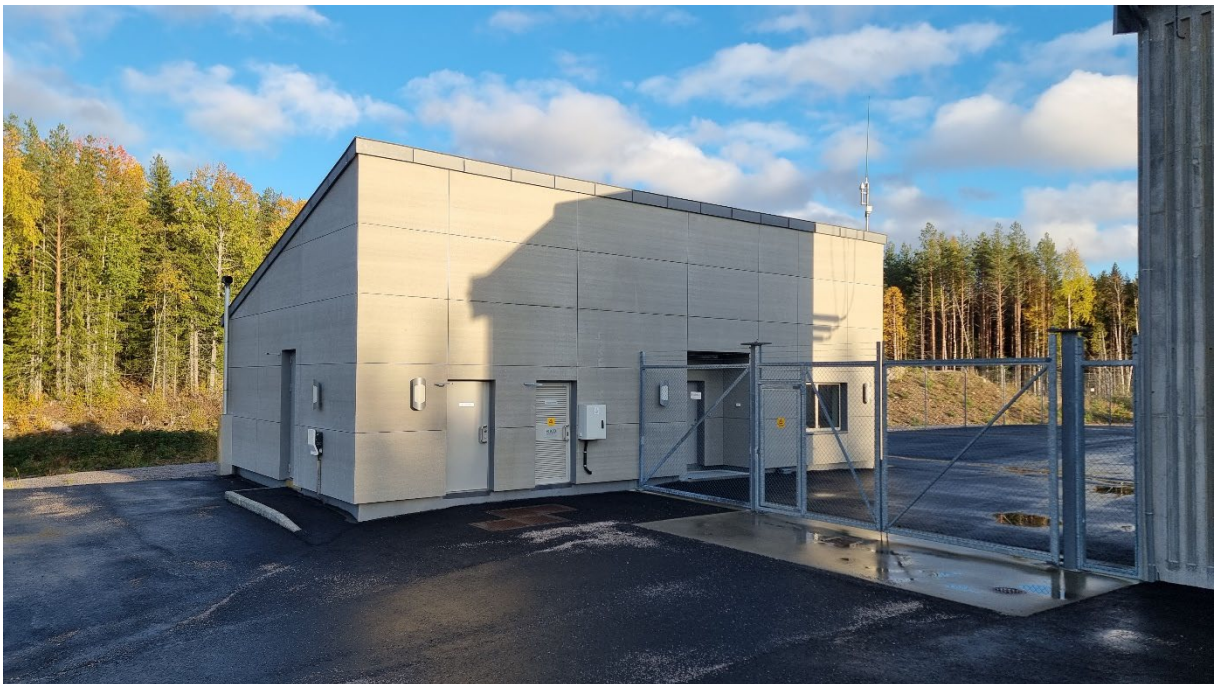
Figur 7: Eksempel på kontrollbygg for Glitre Nett. Her fra Høgefoss transformatorstasjon.
