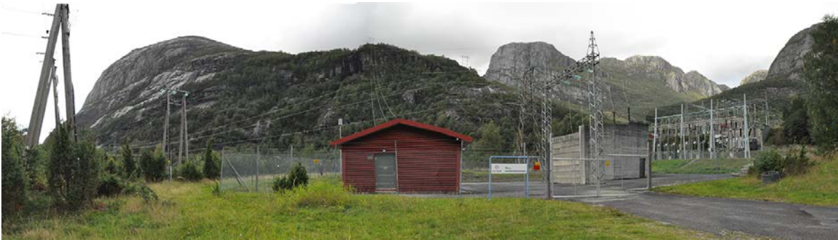
Figur 32. Bildet viser eksisterende transformatorstasjon i Lysebotn. Stasjonen ligger et stykke inn i dalbotnen på et høyereliggende platå og til dette inntrukket mot fjellsida med vegetasjon, som ytterligere er med på å hindre eksponering, i forkant.
