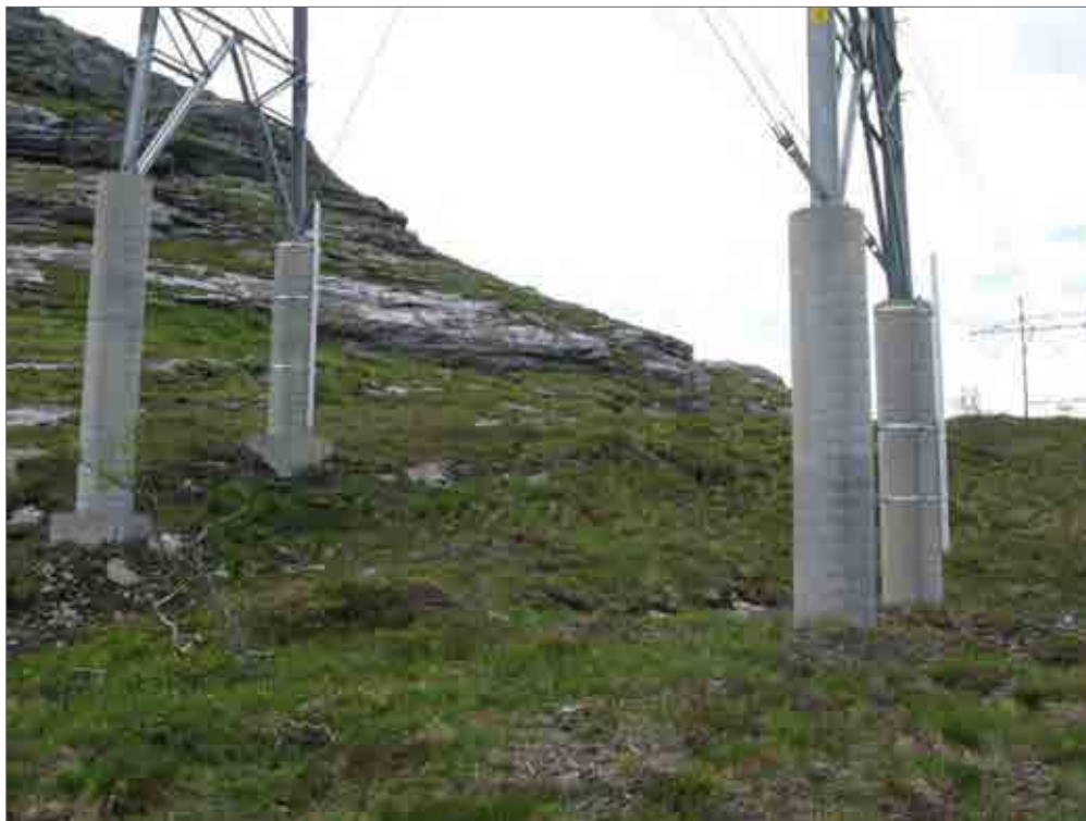
Figur 19. 420 kV bæremast med høye fundamenter som skal tåle snøskred
